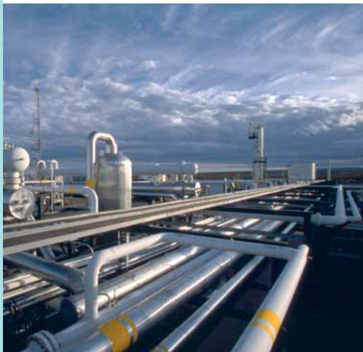
Argentine : gazoducs de l'usine de traitement de gaz d'Aguada Pichana
