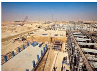
Le schéma très convertissant de la raffinerie de Jubail (Arabie Saoudite) lui permettra de traiter des bruts lourds. Sa mise en service est prévue en 2013.
